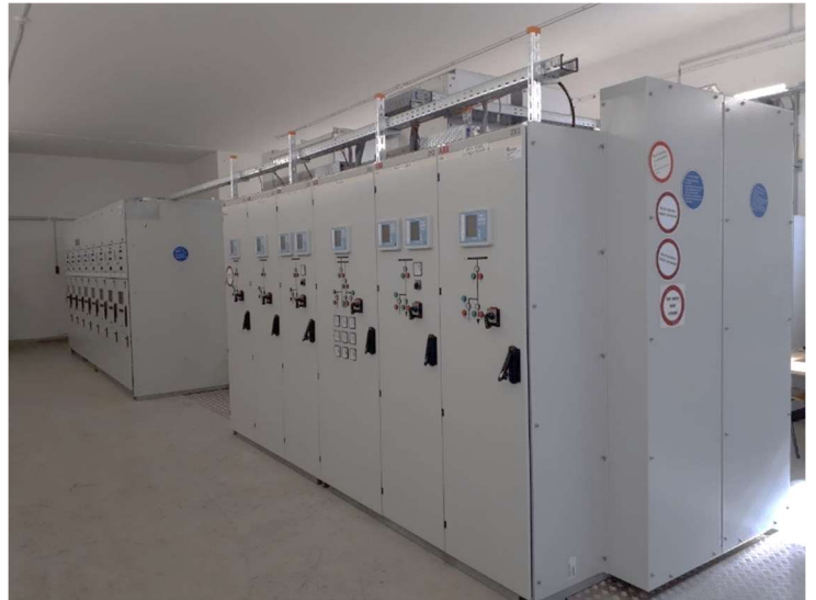
Abbildung 2: USW Heisterbusch nach Umbau
